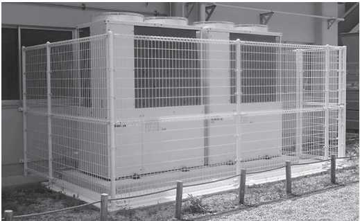
奥殿小学校に設置されたGHP
