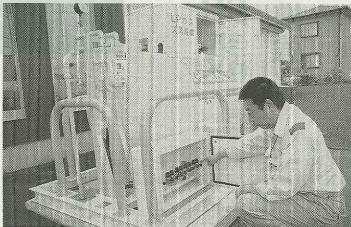
災害時には10力所あるガス栓からガスを取り出し炊き出し用機器に接続する
