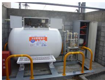
〈プロパンボンベ置場に設置した災害用バルク と備品を収納した倉庫〉
