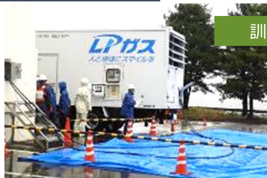
電源車を基地の受電設備に接続
