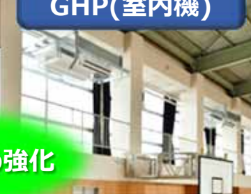
【体育館】 GHP(室内機)
