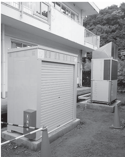
白川小学校に設置した容器庫と8馬力GHP
