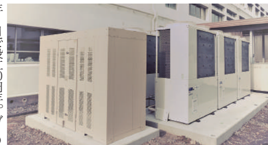
栗東高校に設置された室外機。分散設 置し、供給設備も室外機に近いところ に置いた
