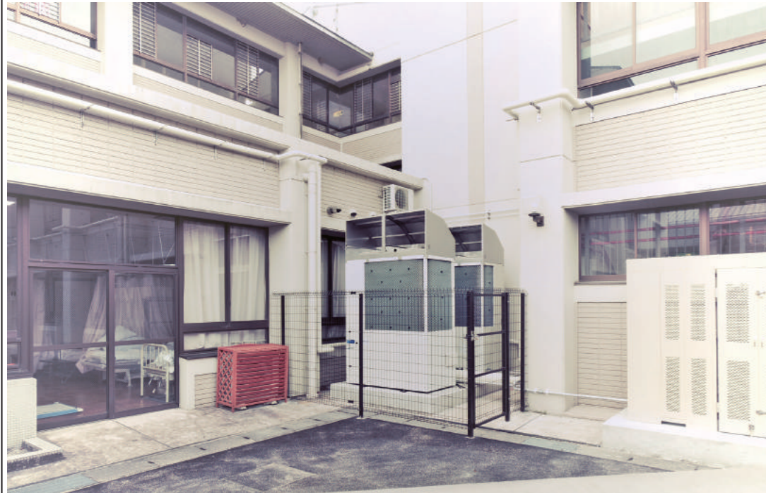
草津養護学校でも配管などを考慮して、最適な場所にGHP、供給機器を 設置した
