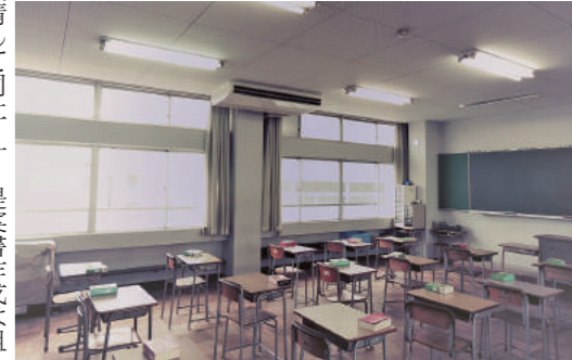
室内機は天井吊形5馬力を1基設置
