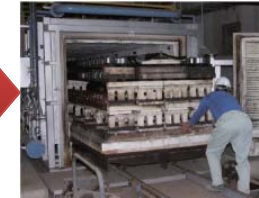
窯業用LPガス炉
