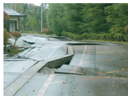
大きく陥没した道路
