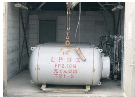
駅弁製造用として 500kg容器を5本設置
